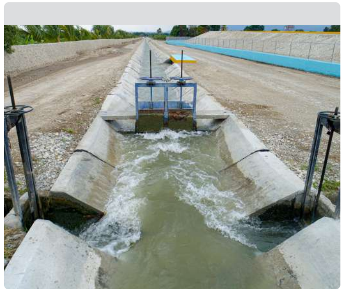
Compuertas de distribución en el lateral V.
