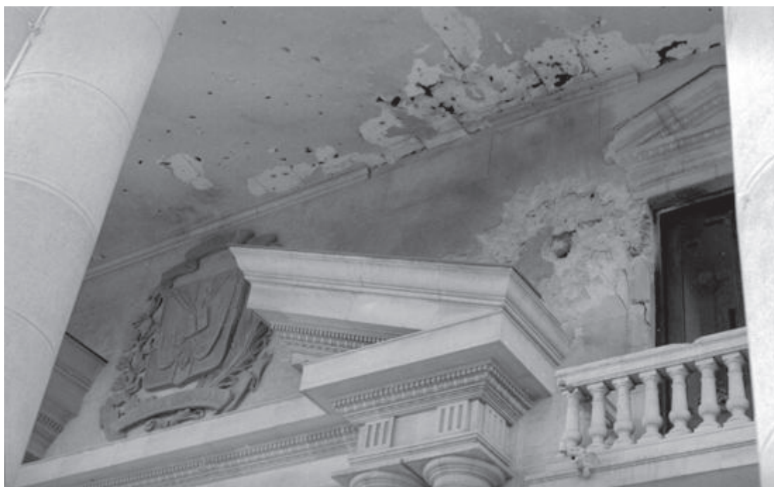
Impactos de metrallas y cohetes de los aviones en el Palacio Nacional
