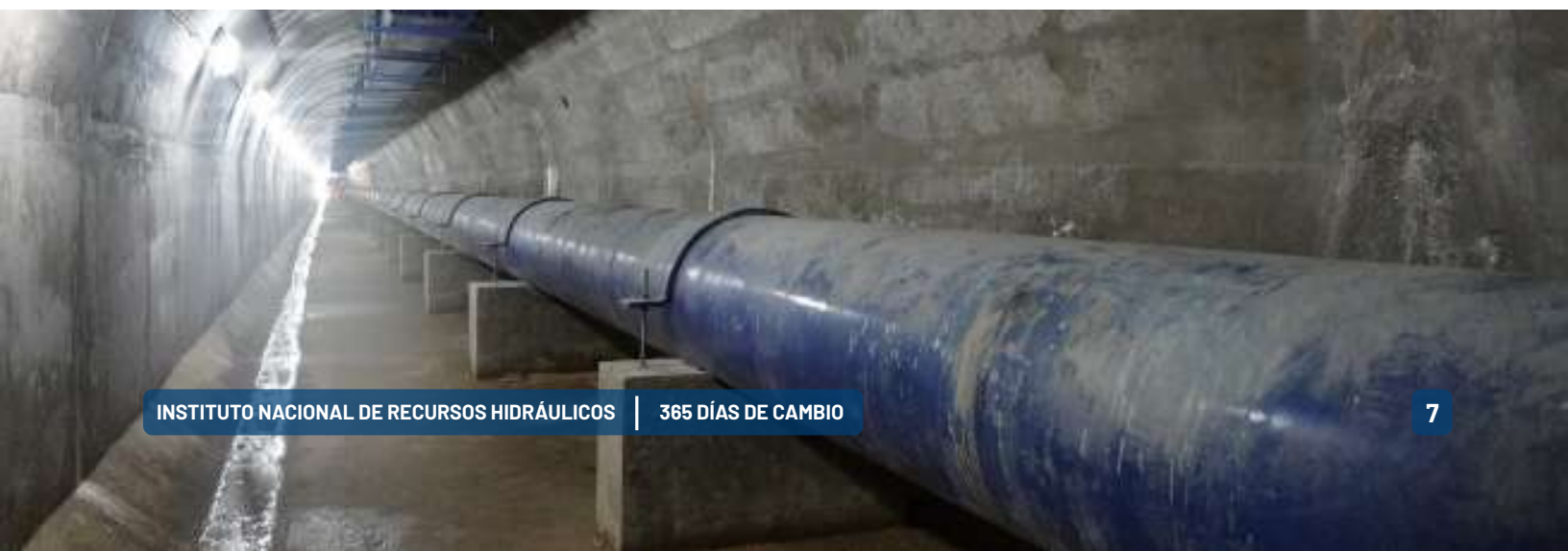
Tubería de interconexión hacia el canal Juan Calvo.
