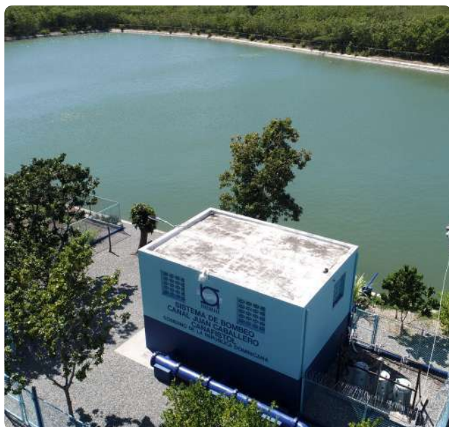
Estación de bombeo del canal Juan Caballero, Cañafistol, provincia Peravia.
