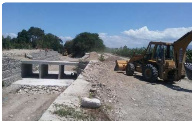
Limpieza después del paso de la tormenta Laura.
