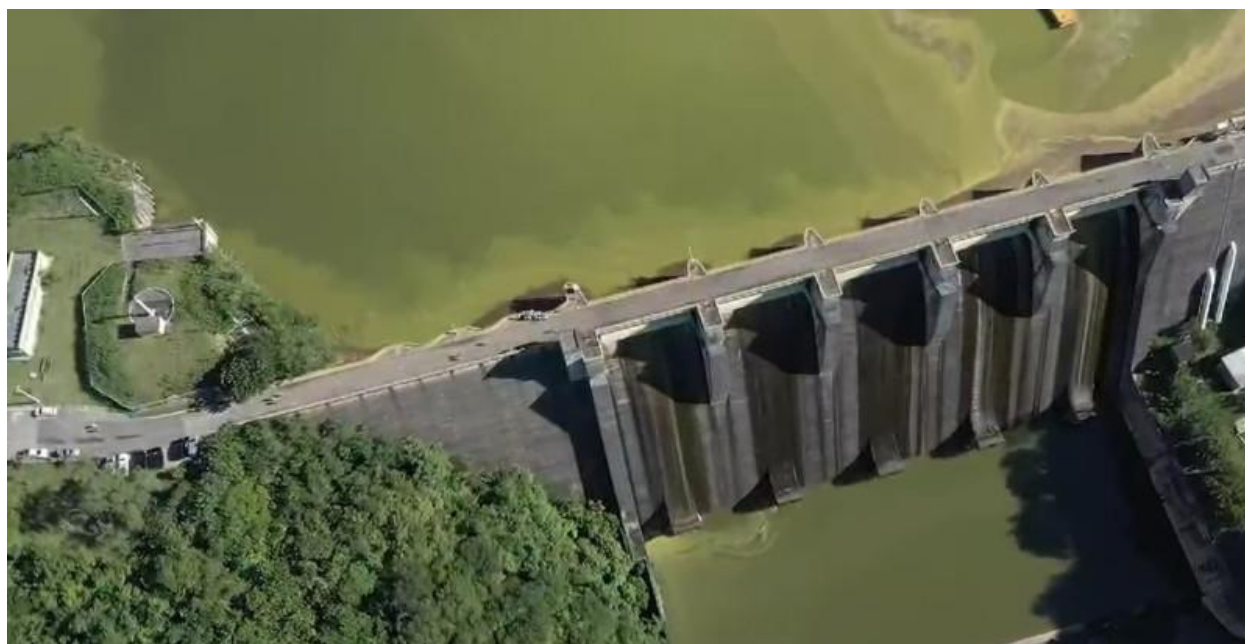
Vista aérea de marcada eutrofización del embalse de Valdesia. Enmanuel Jiménez
